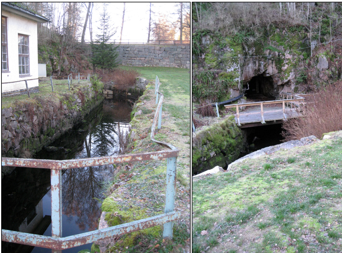
Vattnet leds genom berget från damm 80.
