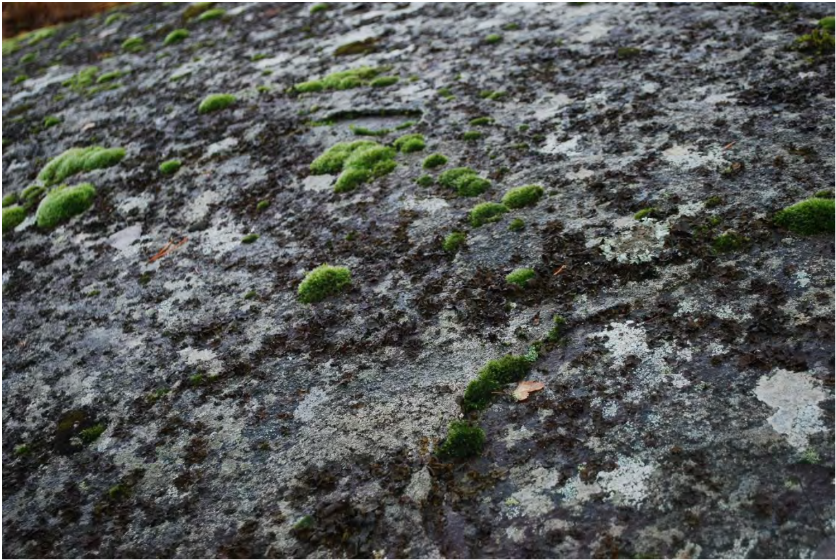
Et inntrykk av flaking og biologisk vekst
