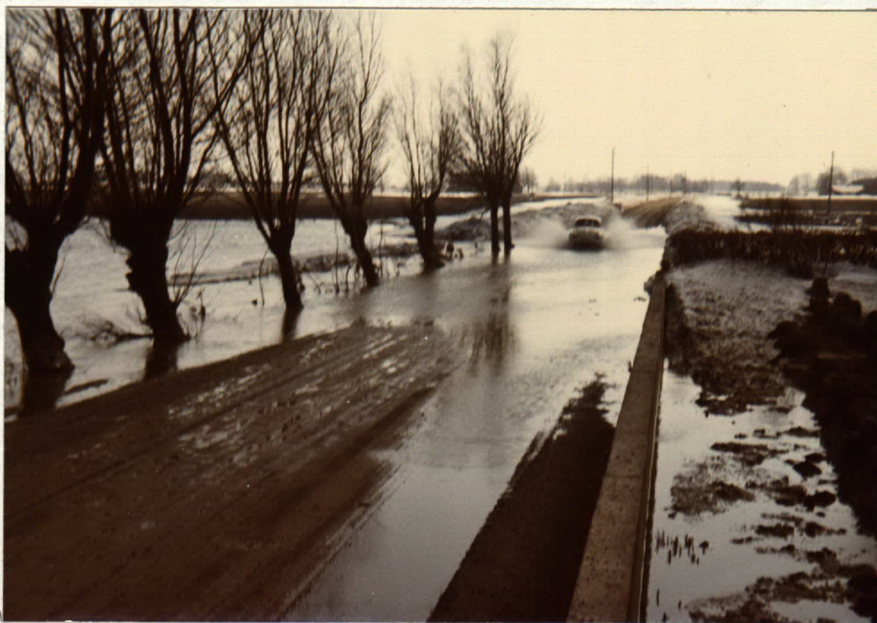
Bilden tagen söderut ungefär vid sektion 12+50. Väg- diket, som går invid pileträden, förmår ej avbörda vattenmängden.
