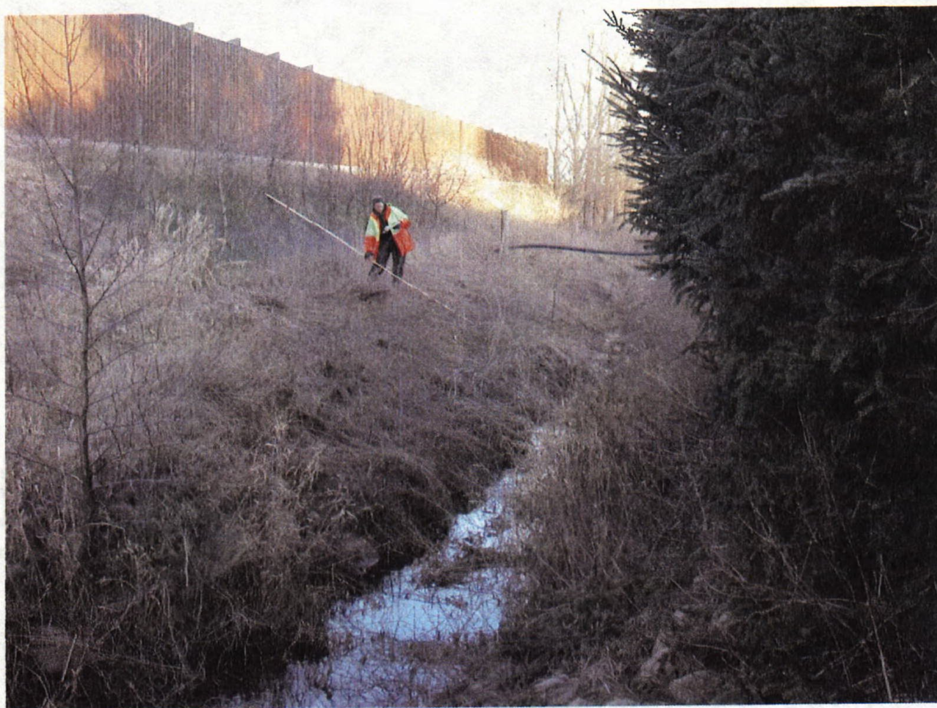
Bild 1. Vy åt öster från inflödet. Omöjligt att rensa från söder, omöjligt att komma över med maskiner till norra sidan. Diket föreslås därför kulverteras från inflödet i Välabäcken och 25 m österut.
