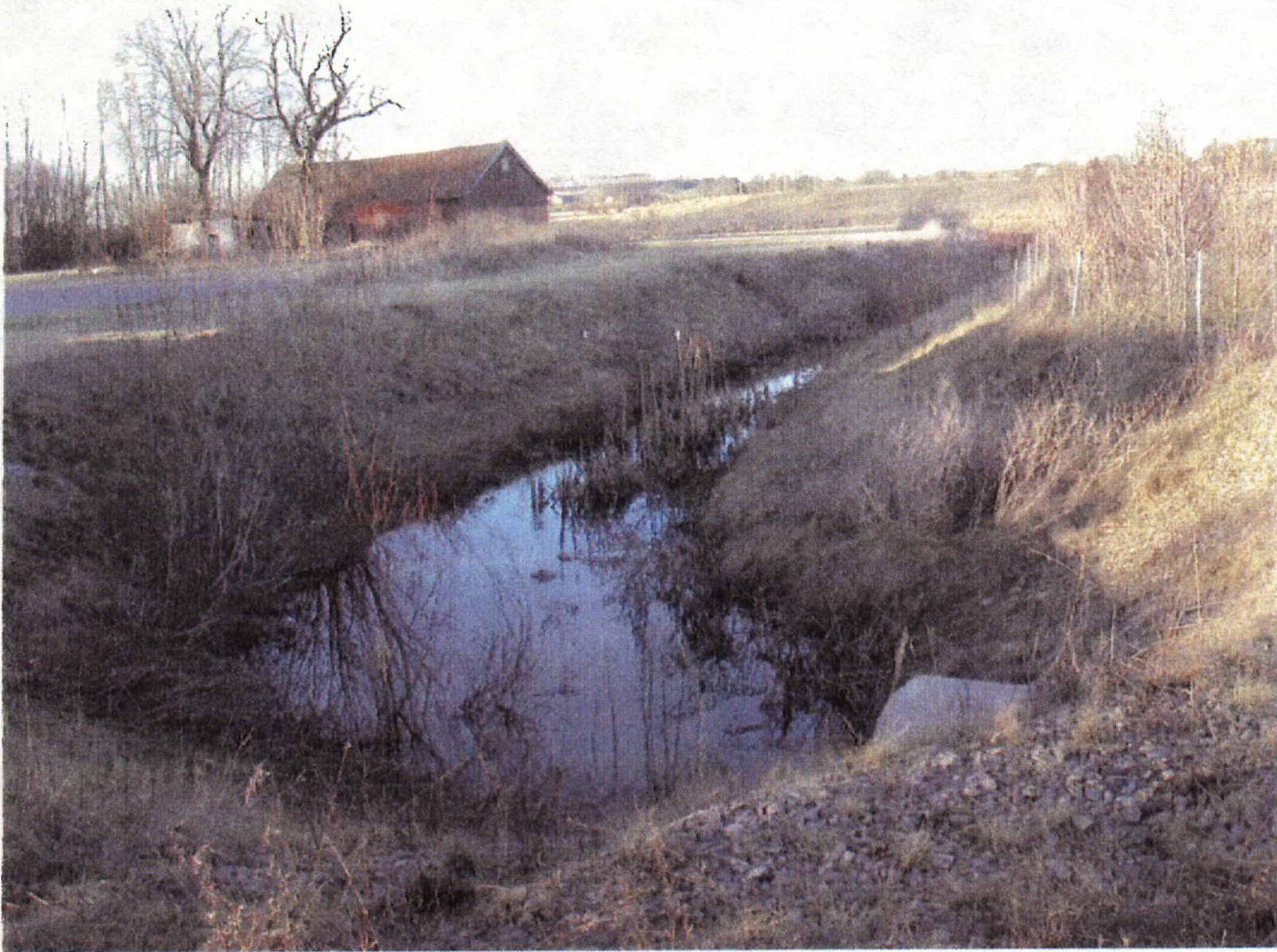
Bild 1. Vy åt nordväst. Vägtrumman behöver förlängas för att möjliggöra passage med maskiner till östra sidan. Anlagd gräsmatta på dikets västra sida.
